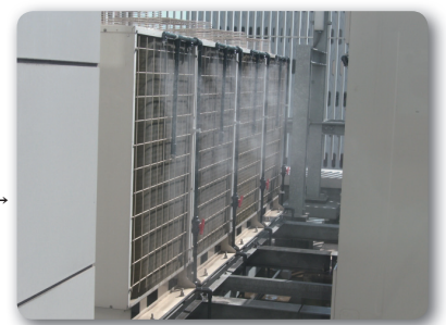
データセンター空調室外機への散水の様子→
